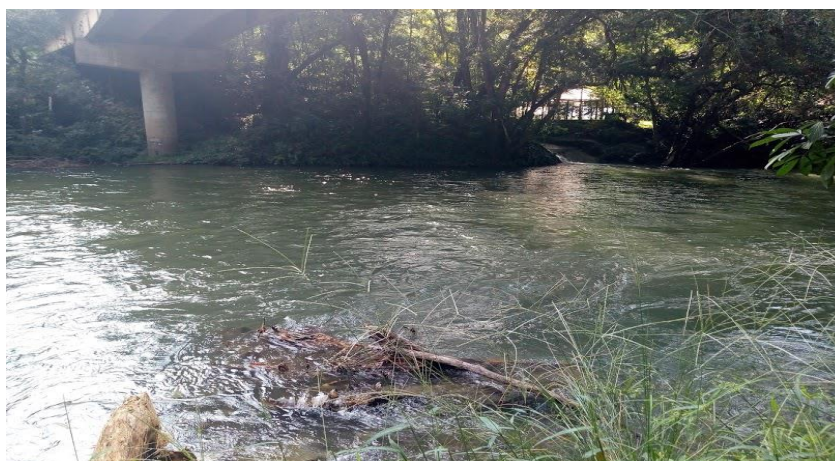
Figura 4: Observación de los desagües identificados a lo largo del Río Claro.
